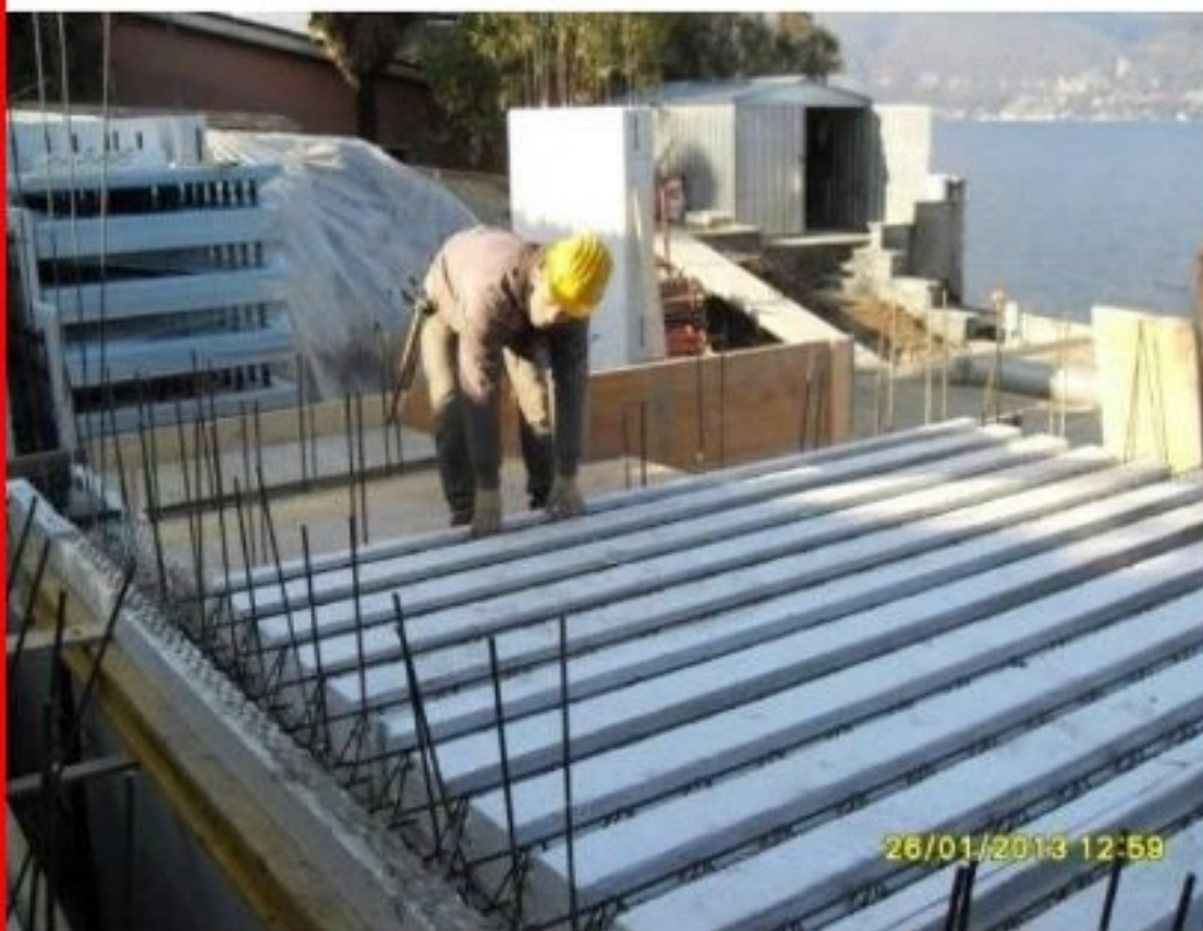
Speedy como entrepiso en ICF
